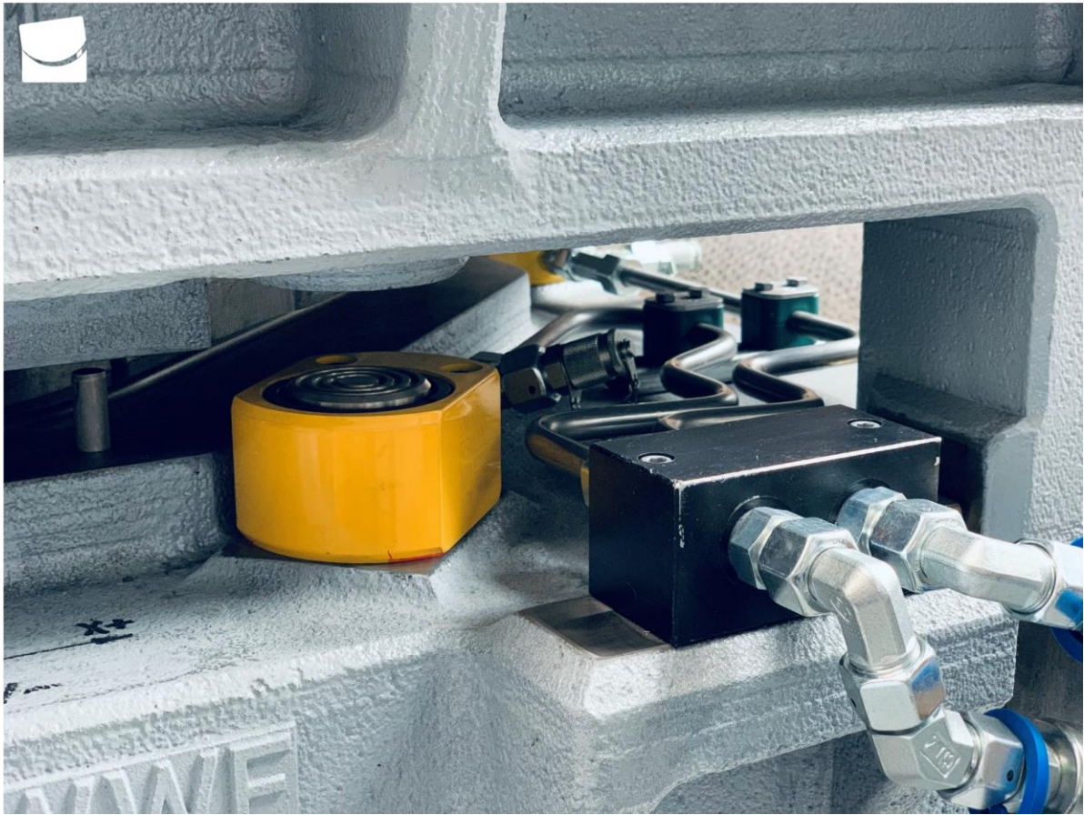
Aktorik der Draw.Control im eingebauten Zustand.
